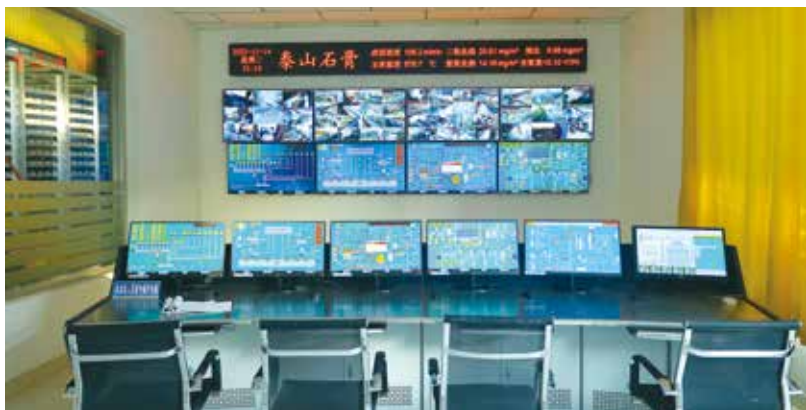
聊城公司中控室
