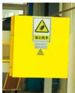
安全风险警示牌
