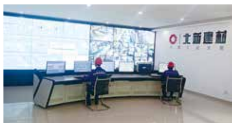
井冈山北新中控室
