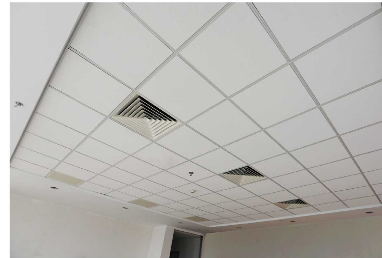
中国电子中央研究院内景 (明架吊顶系统)
