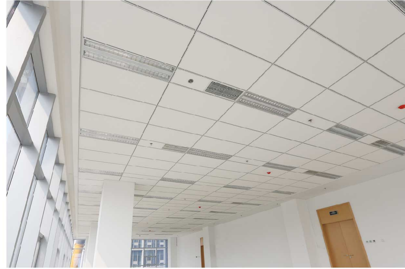
中海油工程技术研究院( 50000m 2 , 跌级米兰花条板, 配套龙牌32平面黑凹槽烤漆龙骨)
