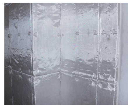
龙牌岩棉(表面覆玻璃布)应用于上海环球金融中心机房、设备间吸声墙
